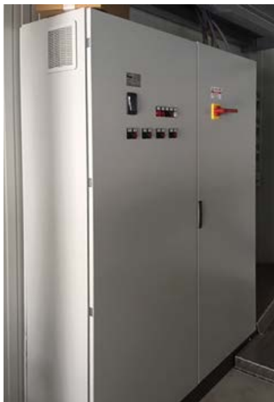
Coffret de contrôle Pego
