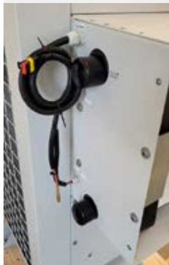
Récupération de chaleur
